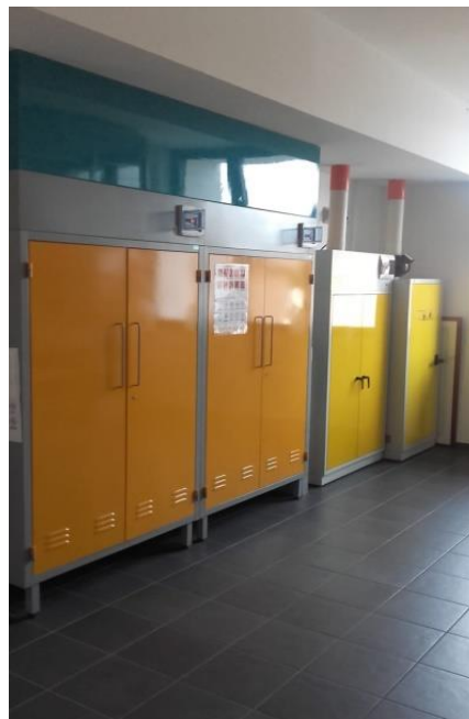
Prelaboratorio – Locale tecnico
